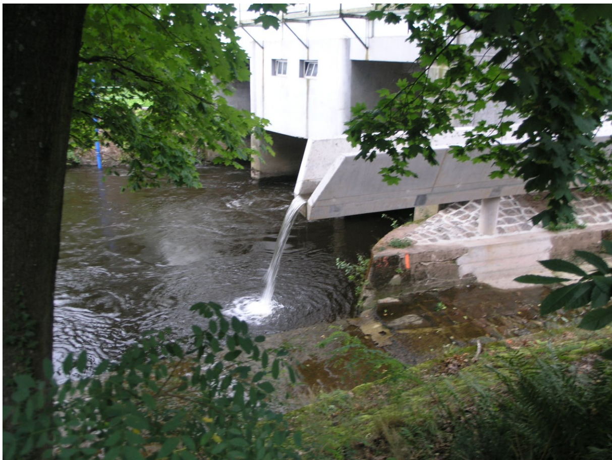
Schadfreie Fischrückführung an einer Fischabstiegsanlage
