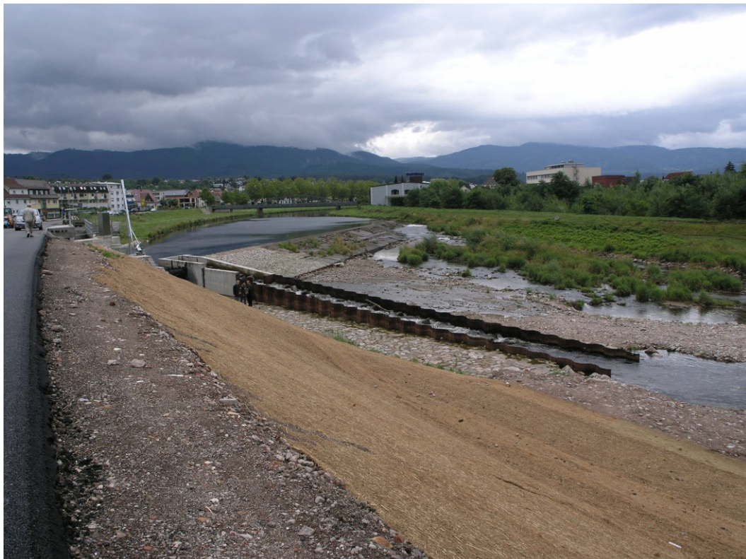
Fischwanderhilfe an einem Ausleitungswehr der Wasserkraft
